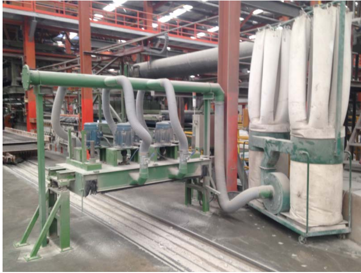
รูปที่ 4 เครื่องความสะอาดแท่นรองรับคอนกรีตมวลเบาด้วยการขัดสีต้นแบบ
